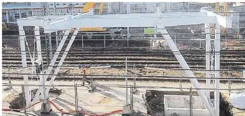
Le pilier central de la passerelle a été posé dans la nuit de jeudi à vendredi.
