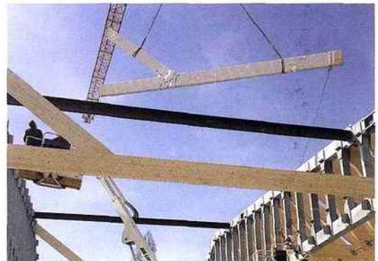
▲ Assemblées en atelier, les pannes-arbalétriers viennent se fixer sur la poutre échelle grâce à des ferrures en âme.
