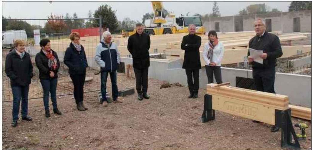
La pose de la première poutre est intervenue le 30 octobre. Document remis
