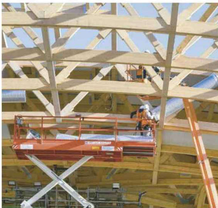
Certaines gaines seront dissimulées dans le plenum afin de souffler en partie haute avec des buses à longue portée.
