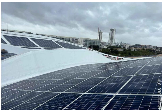
▲ Sur une pente de 38 %, le renfort de fixation des rails Dome Solar permet d'écartier tout risque de fluage sous l'effet de la charge des panneaux photovoltaïques.
